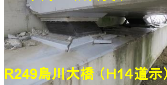
橋台の移動及び ゴム支承の残留変形
