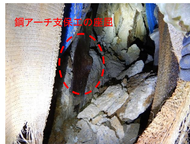
鋼アーチ支保工の座屈
