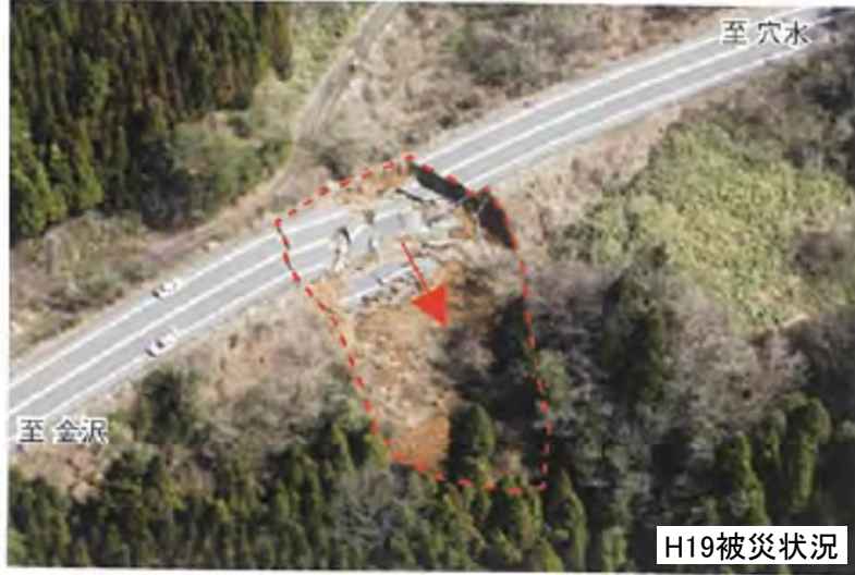
上下線の崩落 (H19.3月)
