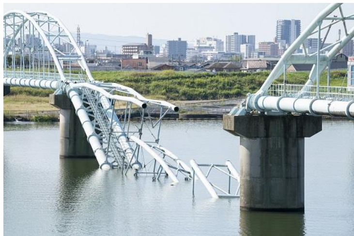
(写真) 近畿地方整備局HPより
