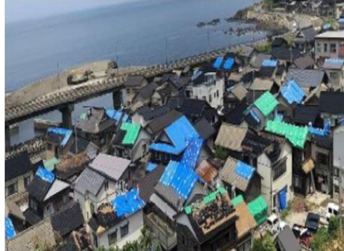
住宅の屋根瓦の落下
