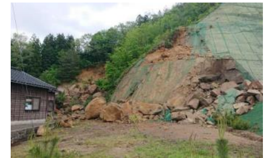
がけ崩れによる被害(石川県珠洲市正院町)
