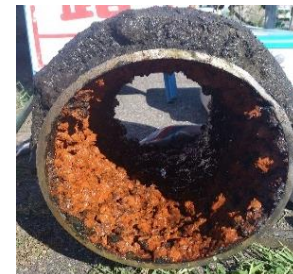
管路の老朽化
