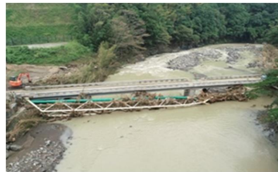
被災して崩落した水道管
