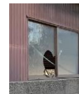
窓が割れた管理不全空家
