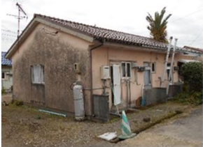
老朽化した公営住宅
