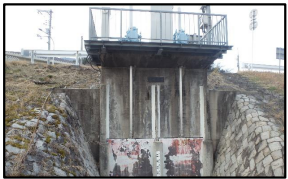
〔劣化した河川ゲート〕
