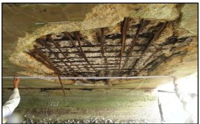
〔内部の鉄筋が露出した橋梁〕
