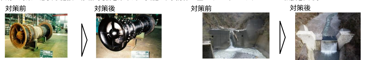
老朽化したポンプ設備の修繕・更新により、災害のリスクを軽減 常時流水の影響による摩耗の進行 高耐久性材料を活用した改築
