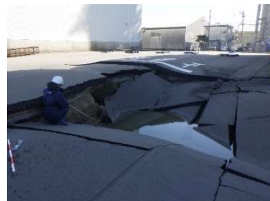
ふ頭用地の陥没(金沢港)
