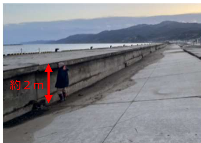
岸壁背後の沈下(輪島港)
