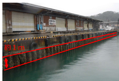
地盤の隆起(輪島港)
