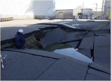
ふ頭用地の陥没(金沢港)
