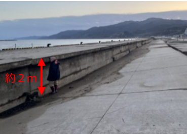
岸壁背後の沈下(輪島港)
