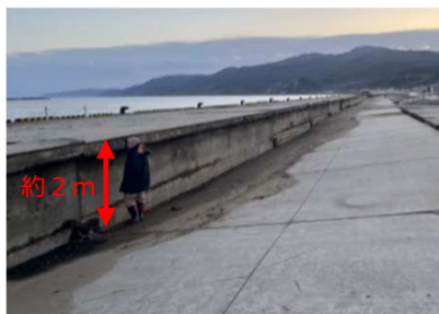
岸壁背後の沈下(輪島港)
