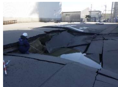
ふ頭用地の陥没(金沢港)
