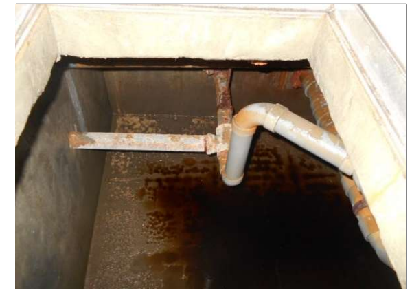
便所床下: 漏水による錆びが発生している。
