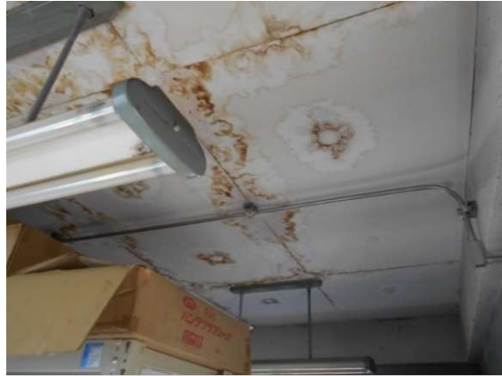
棟屋2階: 漏水が多数発生している。
