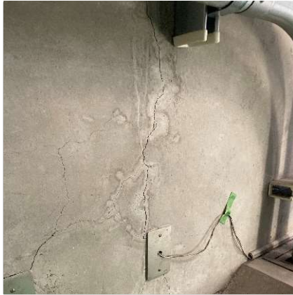
受変電室: クラックからの漏水が多数発生している。
