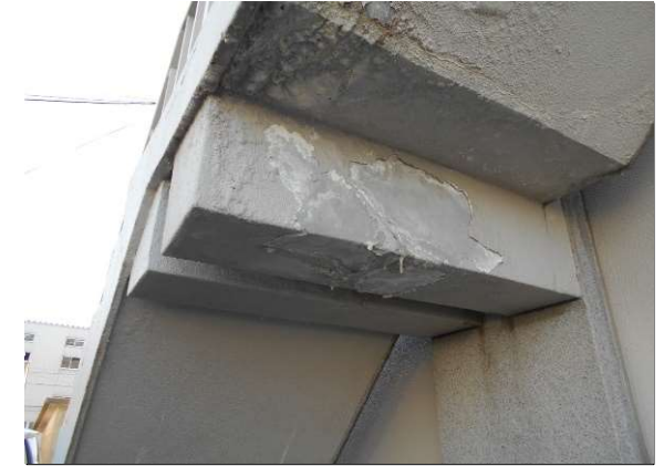
屋外階段: 剥離・浮きが発生している。
