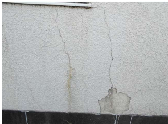
東側外壁: ひび割れのほか、浮き、剥離が多数発生している。
