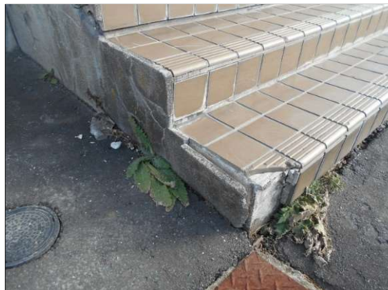
庁舎入口階段: ひび割れ、剥離が発生している。
