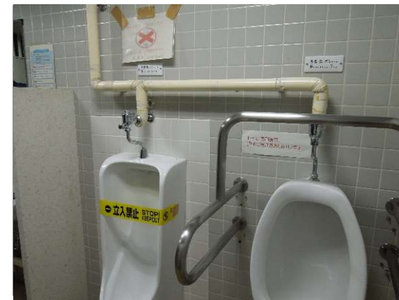
1階男子便所: 排水が詰まり、小便器が使用できない状態。
