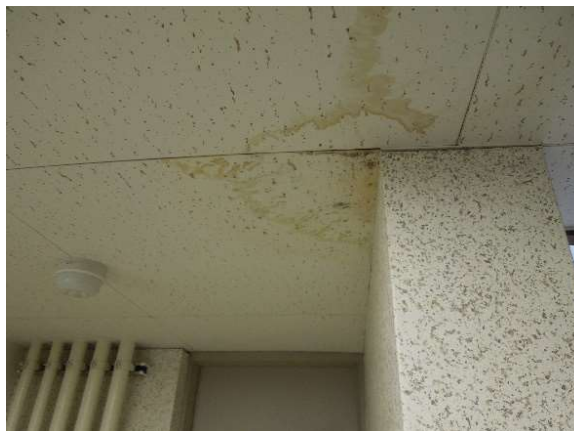
2階廊下: 天井に漏水が見られる。
