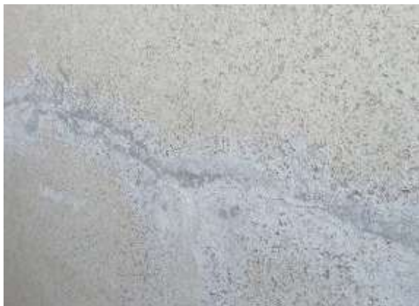
階段室: 内壁にひび割れが発生している。
