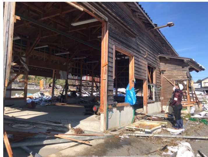
▲被害調査の様子
