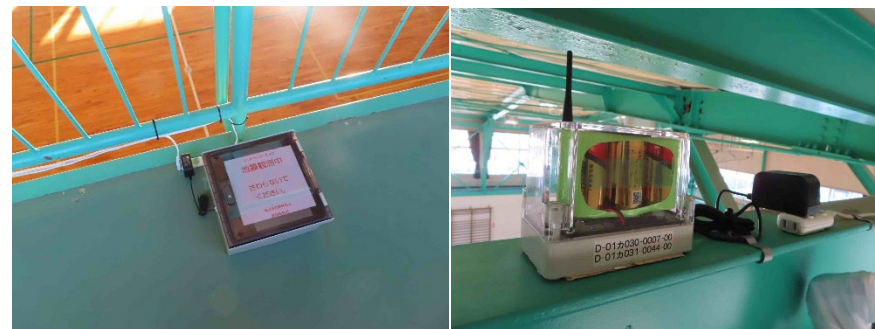
▲つくば市内小学校体育館への地震計設置
