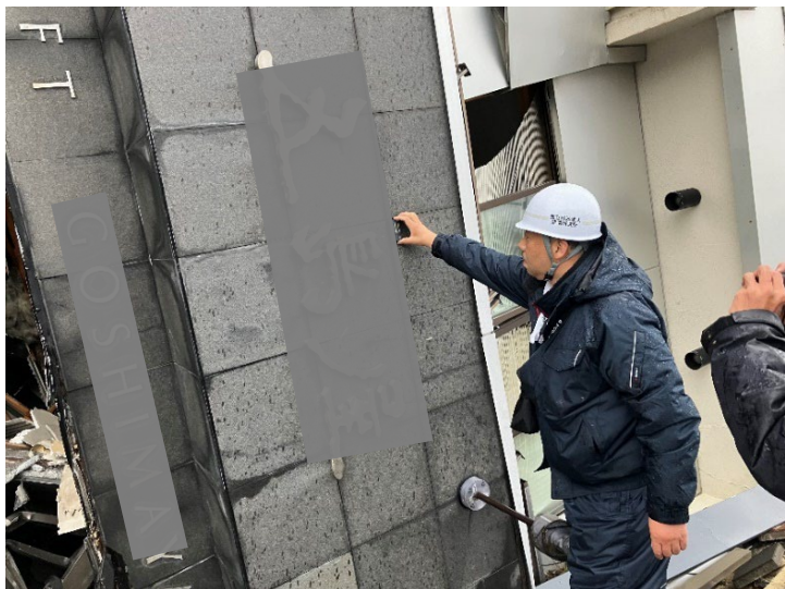
▲被害調査の様子
