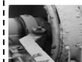
揚錨機の腐食・電装品の劣化
