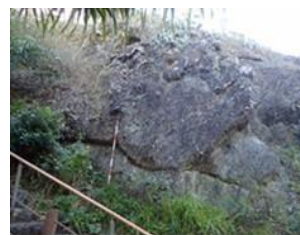
急傾斜地の落石危険箇所
