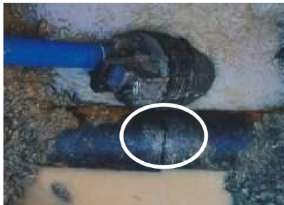
地中で折れた水道管
