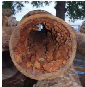
錆による水道管の腐食
