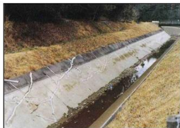
開水路のひびわれ
