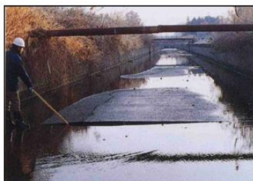
水路底の浮き上がり
