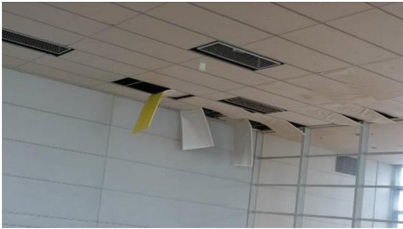
天井の落下被害
