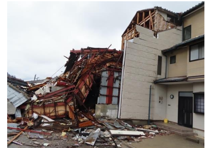
鉄骨造建築物の2階と3階が倒壊
