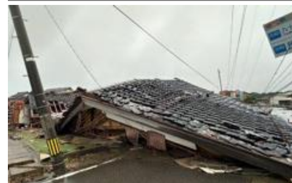
倒壊した木造建築物
