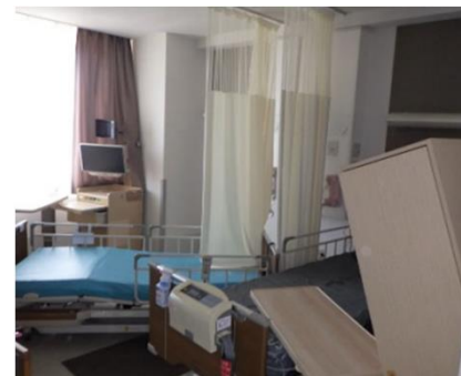
耐震構造の病棟の地震後の状況
