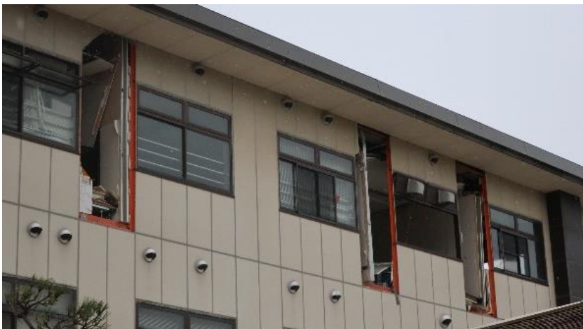
外壁の脱落被害
