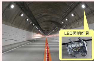
道路照明のLED化
