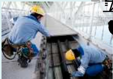
明石海峡大橋に添架されている電力ケーブル 出典）関西電力送配電HP
