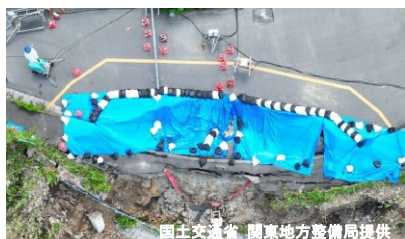
△変状の進行のモニタリング
