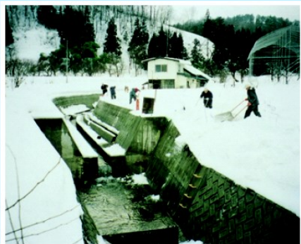
除排雪低水路（山形県村山市）
