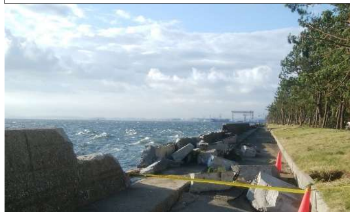
護岸の損傷（横浜港）
