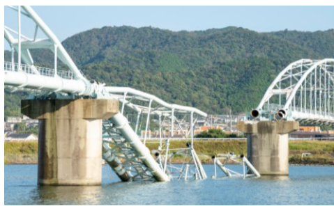
六十谷(むそた)水管橋落下の様子(和歌山県)令和3年
