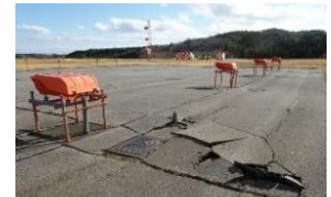
能登空港の被災状況
