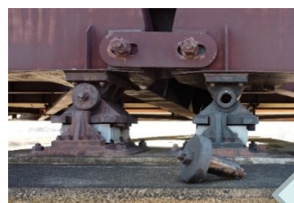
地震による支承 (G1側)の損傷
