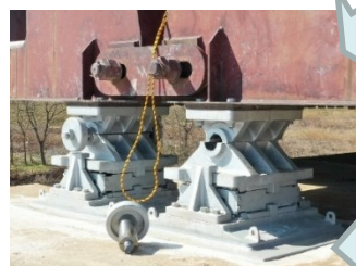
再度、地震による支承 (G2側) の損傷
