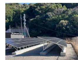
太陽光発電施設
