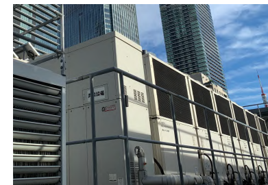
屋上の省エネ設備
