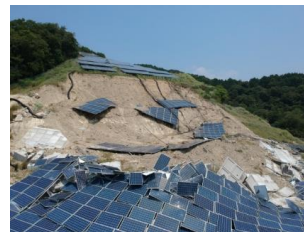
土砂崩れで生じた崩落
