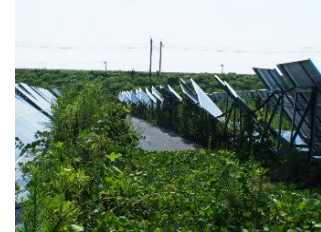
不十分な管理で放置されたパネル
