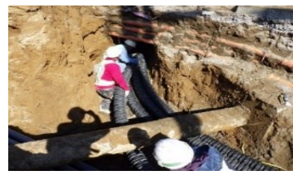
角型多条電線管の整備事例
