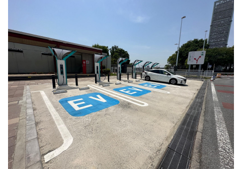
【道の駅等でのEV充電器の設置】
