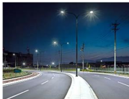
LED照明 (消費電力約56%削減)
