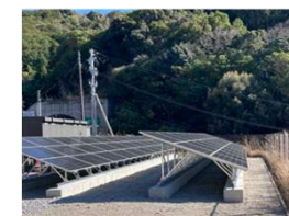
太陽光発電施設
