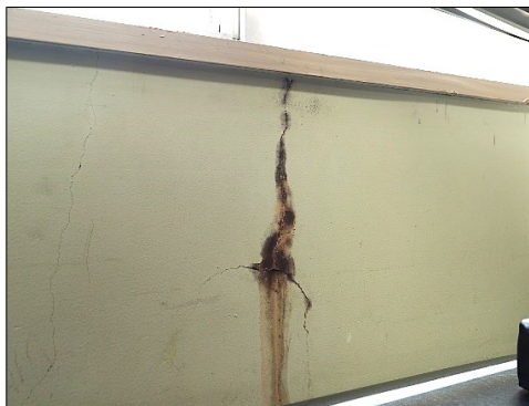
2階事務室・認定室 外壁のクラックにより漏水が発生している。
