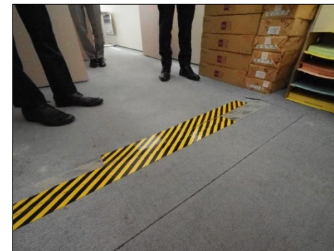
2階事務室 経年に伴い床の高さにずれが生じ、室内に段差が生じている。
