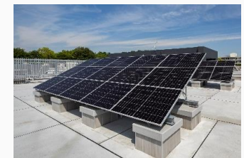
【太陽光発電設備の設置例】
