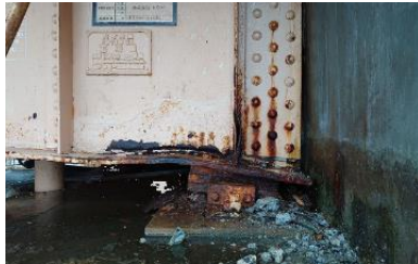
支点部の主桁が座屈した事例
