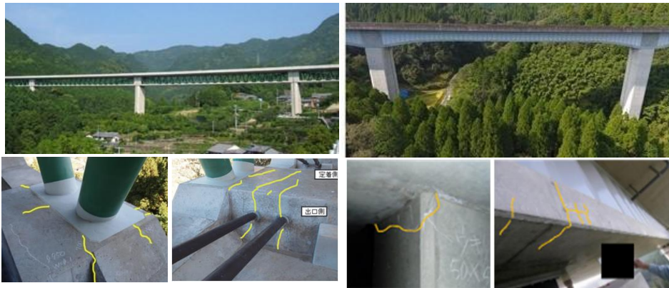
格点部の損傷
