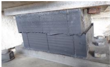
支承が破断した事例
