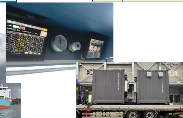
船内監視・陸上サポートシステム（船内監視画面）（左）とコンテナ型バッテリーシステム（300kWh、マイナビニュースHP）（右）
