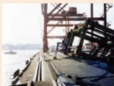
兵庫県南部地震の被害
