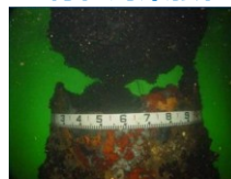
【鋼管杭の腐食の進行】
