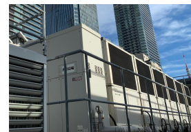
屋上の省エネ設備
