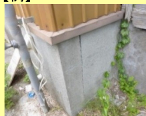
基礎にひび割れがないか
