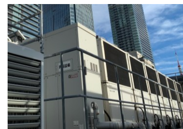
屋上の省エネ設備
