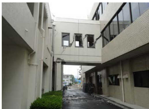
庁舎における構造部材の損傷
