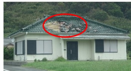
強風による屋根の被害(南房総市)
