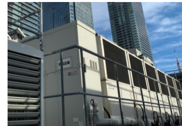
屋上の省エネ設備
