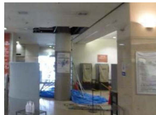
病院における天井の損傷
