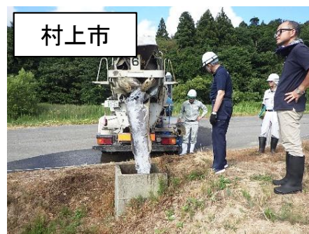
農業用水路への給水状況
