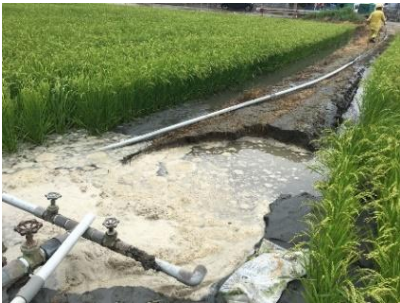
漏水事故（支線水路）
