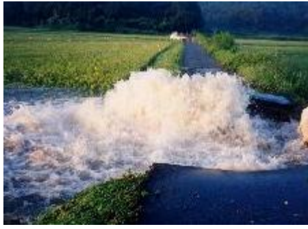
坂祝支線での漏水
