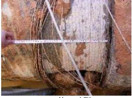
P C 管の破裂
