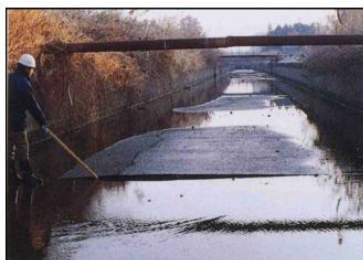
水路底の浮き上がり
