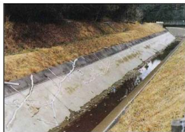
開水路のひびわれ
