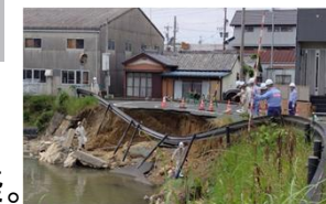
R5.6山中川の被災状況調査 (愛知県豊橋市)
