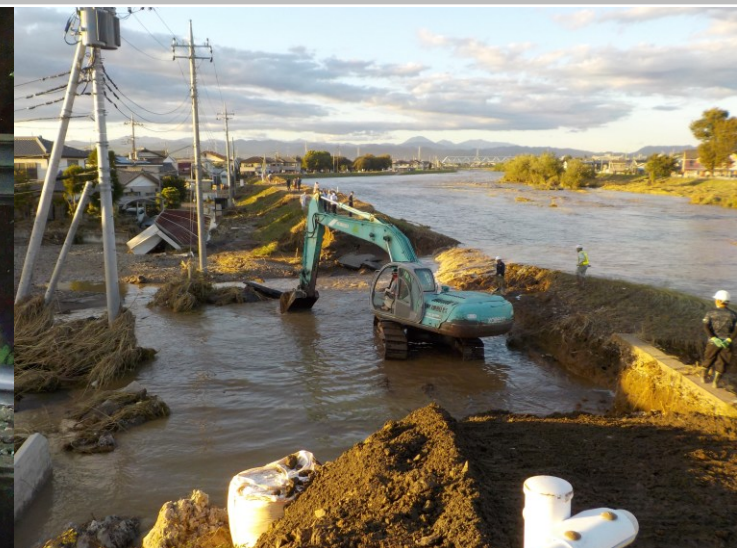
【令和元年 東日本台風】
