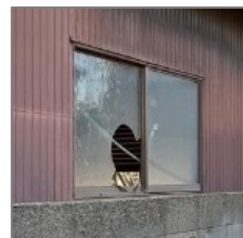
窓が割れた管理不全空家のイメージ
