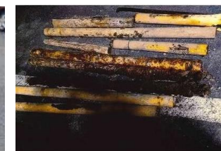
陥没箇所を掘削した結果、 確認された残置物（管路）
