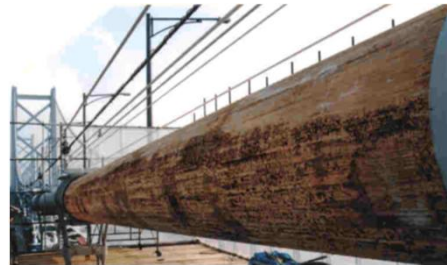
亜鉛めっき鋼線に腐食※を確認 [北備讃瀬戸大橋、1993年(供用5年目)調査] ※写真の茶色はペーストの色
