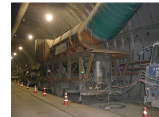
写真：防爆型大型換気設備
