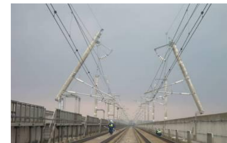
平成23(2011)年 東北地方太平洋沖地震 東北新幹線の被害状況
