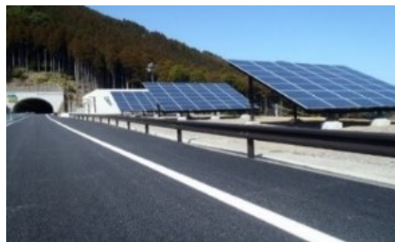
道路における太陽光発電の活用
