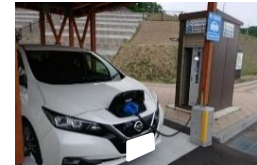
道の駅でのEV充電状況
