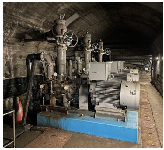
排水ポンプ (設置から14~30年経過)
