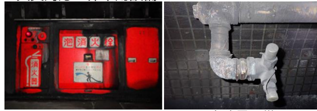
消火栓 (設置から26年経過)
