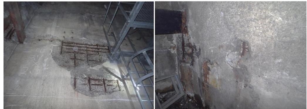
鉄筋露出状況
