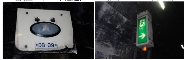
火災検知器 (設置から11年経過)
