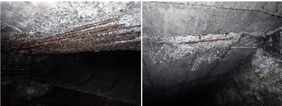
鉄筋露出状況
