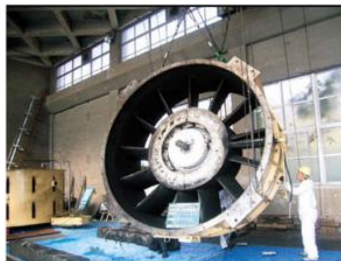
排風機分解設備
