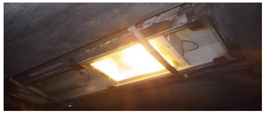
照明設備 (設置から22年経過)
