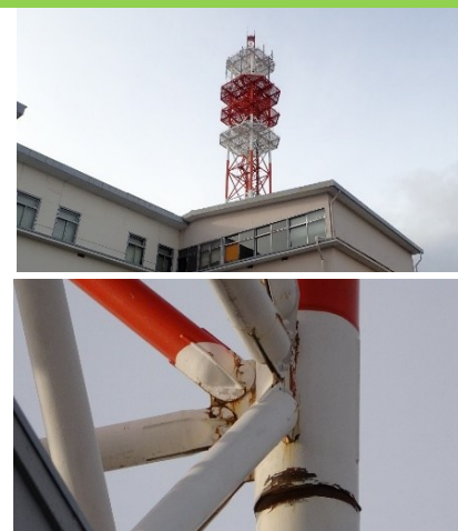
▲被災したNTT青森八戸ビル鉄塔
