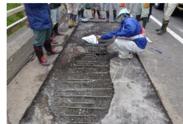
床版の土砂化
