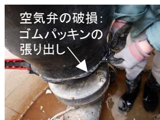
図1 地震時における空気弁の破損状況 (空気弁上部と下部に挟まれるゴムパッキンが張り出して漏水した)
