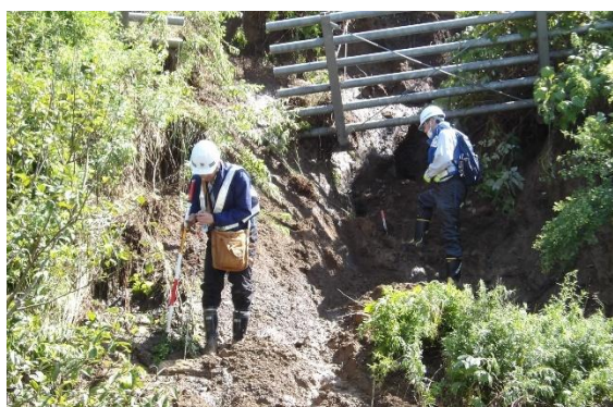
写真-1.2.1.3 切土のり面崩壊の発生状況
