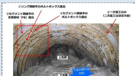
現場の画像から構造および損 傷程度を推定し助言（トンネル）
